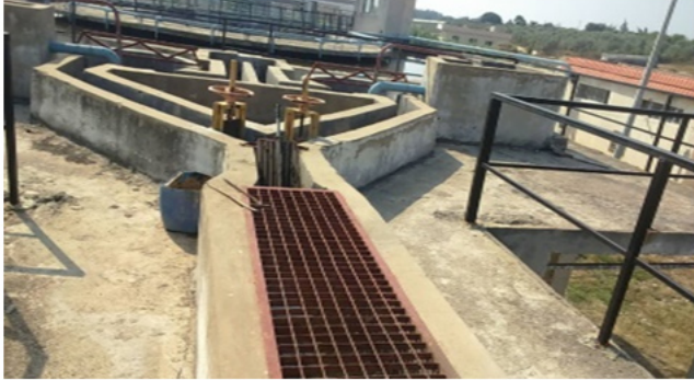
الشكل 3. احواض فصل الرمال.
